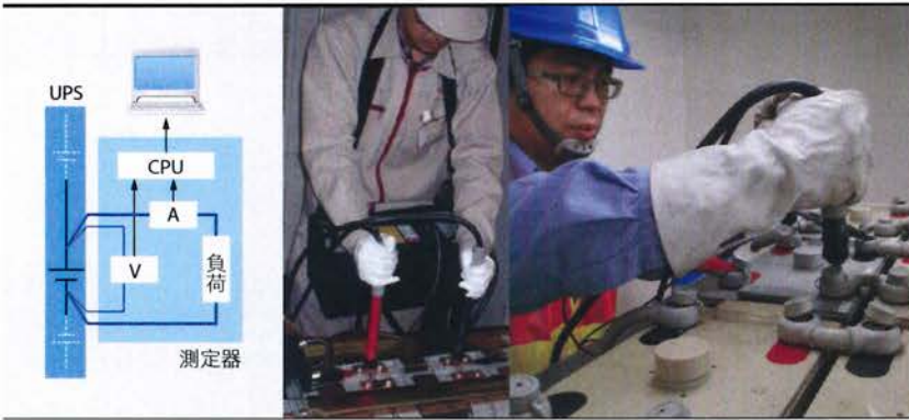
圖 12、日本 UPS 現場活線大電流測試
