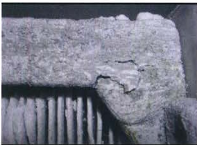
圖 5、故障電池硫酸鉛結晶連接鉛橋斷裂
