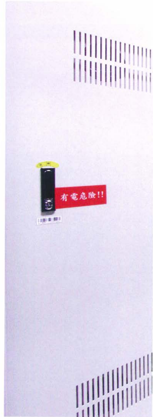
十二廠六期直流電源供應盤 攝影 / 洪湘寧
